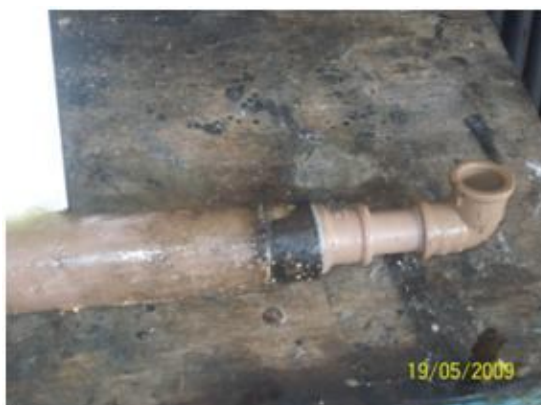
Figura 3.14. Entrada de água quente do coletor.
