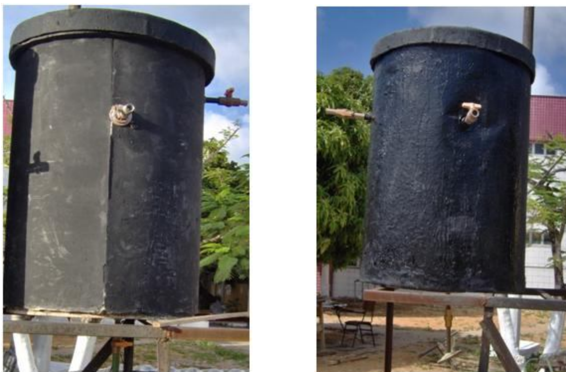
Figura 3.21. Reservatórios térmicos RT 200 e RT 150 do sistema de aquecimento solar utilizados.
