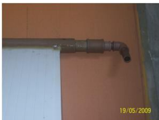
FIGURA 3.13. Saída de água quente do coletor.
