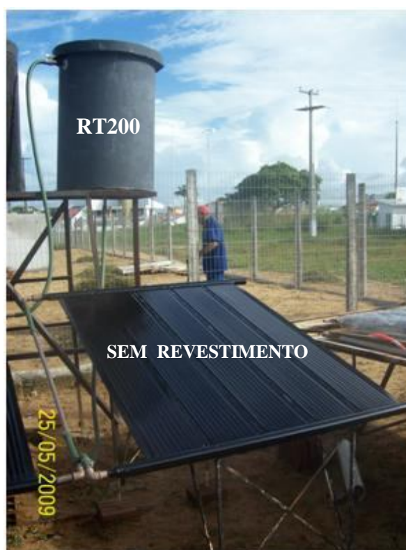
FIGURA 3.24. Sistema de aquecimento solar sem revestimento metálico (CONFIGURAÇÃO III).
