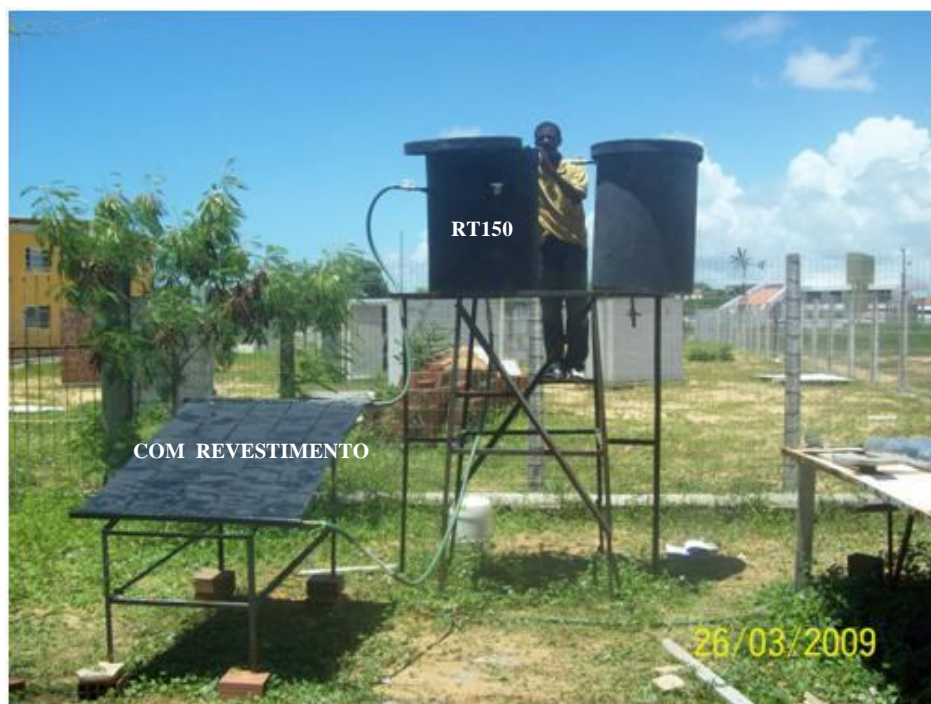
FIGURA 3.23. Sistema de aquecimento solar com revestimento metálico (CONFIGURAÇÃO II).
