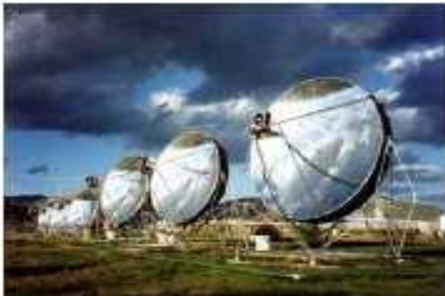
Figura 2.19. Campo Solar Eurodish na Alemanha.
