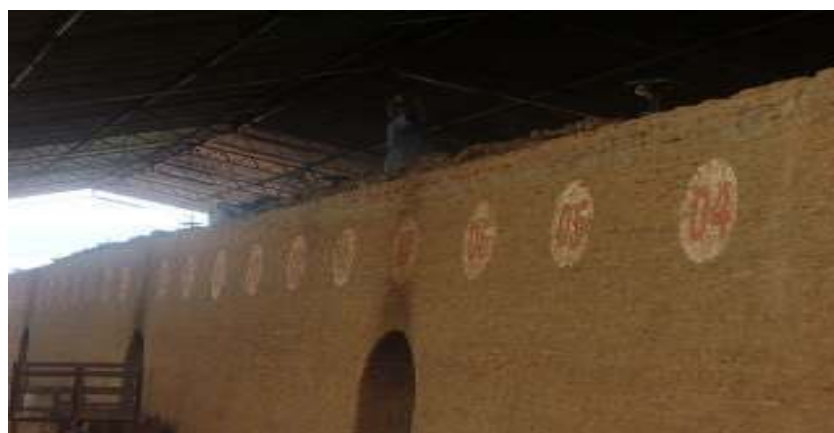
Figura 12: Vista lateral dos fornos contínuos
