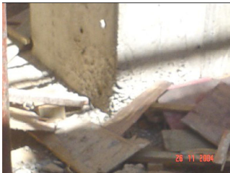
Figura 5.2 – Defeitos em pilares provenientes de falhas na execução.
