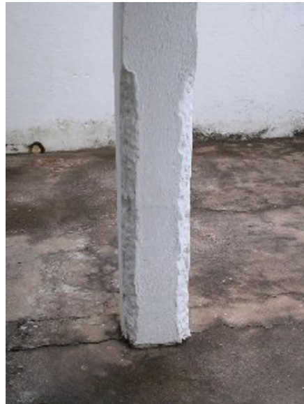
Figura 5.3 – Intervenção inadequada realizada pelo usuário.
