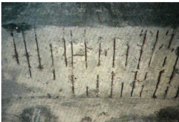
Figura 2.6 – Corrosão generalizada da armadura de uma laje devido ao ataque por cloro, com desagregação do concreto de cobertura.
