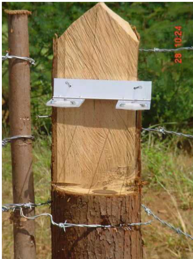
Figura 3.7 Placas Alcalinas instaladas.
