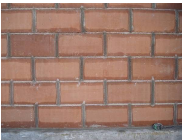
Figura 7.10: Montagem da parede para o teste de isolamento sonora. As juntas verticais e horizontais foram cuidadosamente preenchidas com argamassa.
