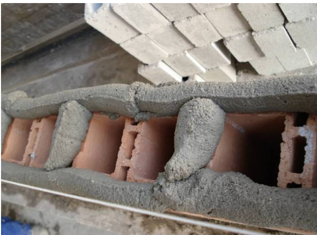
Figura 6.2: Montagem de parede para teste de isolamento sonora, com detalhe à colocação da argamassa.
