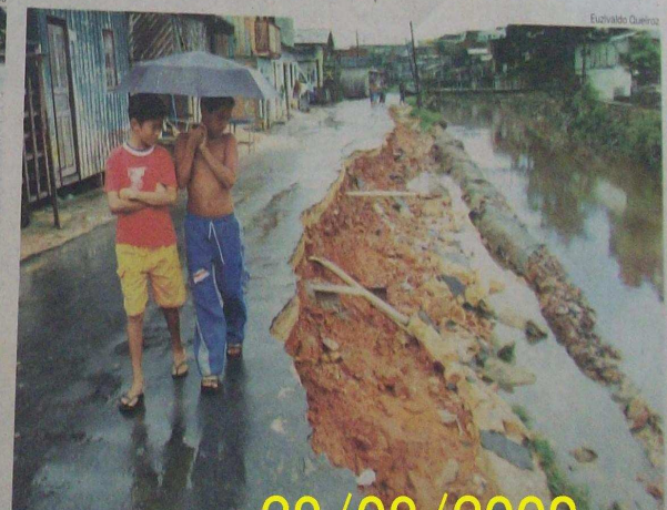
Força da chuva destruiu parte do rip-rap na avenida Efigênio Sales, no bairro Santo Agostinho
