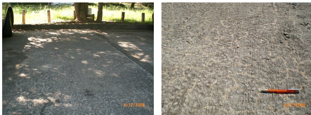
Figura 3.4 Fissuras transversais na superfície da pista experimental.
