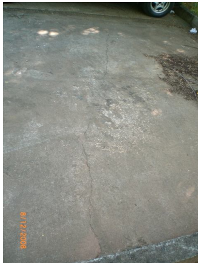
Figura 3.6 Fissura na placa A3 da pista experimental.
