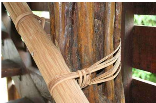
Figura 497 – Detalhe da fixação da estrutura - Sede do ISA. Fonte: Acervo do escritório Brasil Arquitetura.
