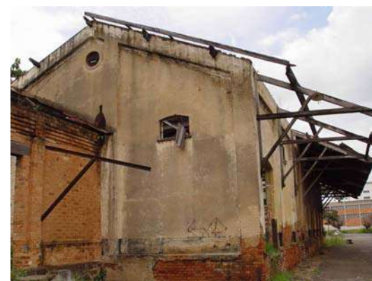
Figura 398 – Levantamento do estado de conservação dos prédios da Estação de Trem de Araras. Fonte: Acervo do escritório Brasil Arquitetura.
