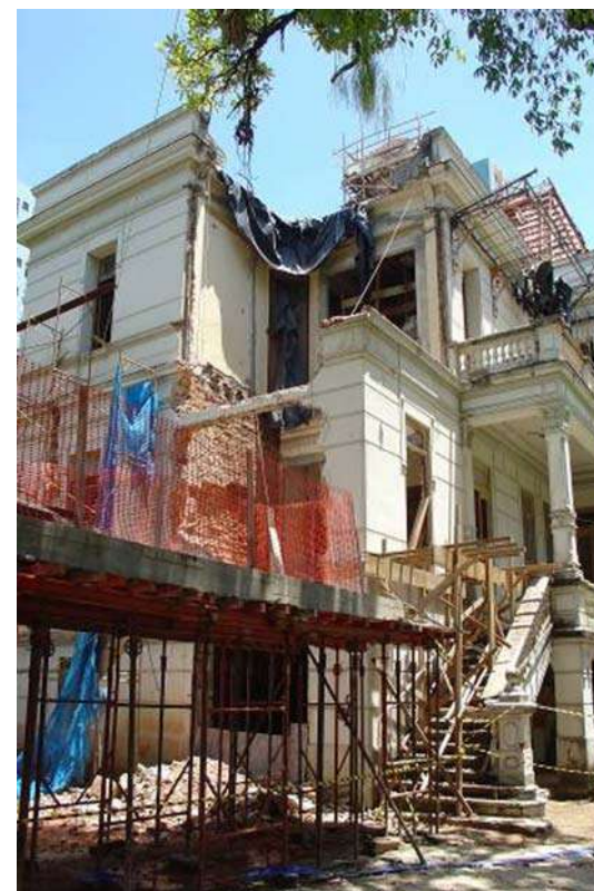
Figura 335 – Execução de demolição para implantação da nova circulação vertical no palacete. Fonte: Acervo do escritório Brasil Arquitetura.
