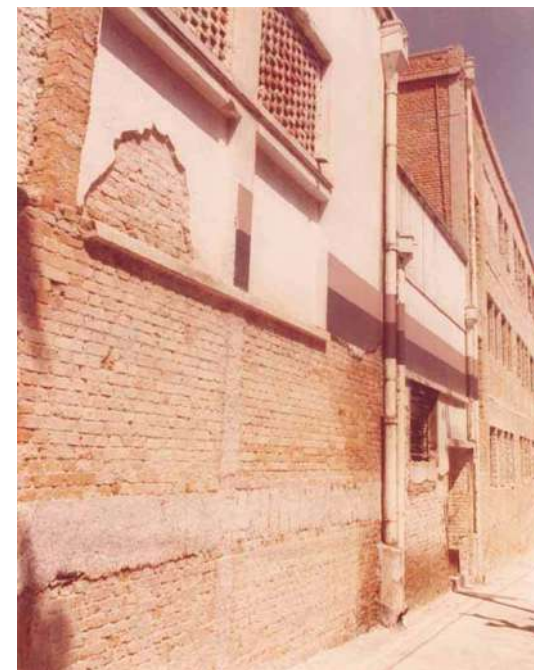
Figura 002 – Estado dos galpões do Sesc Pompéia antes da intervenção. Fonte: Acervo do escritório Brasil Arquitetura.
