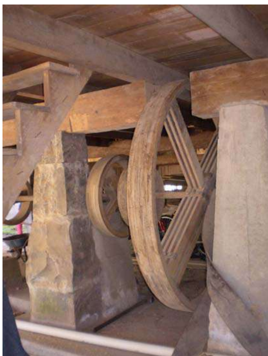
Figuras 394 e 395 – Porão do moinho durante as obras (outubro de 2007). Fotos: Patricia Viceconti Nahas.
