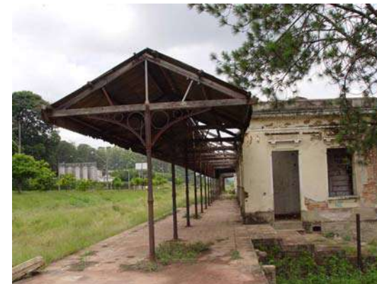
Figura 397 – Levantamento do estado de conservação dos prédios da Estação de Trem de Araras. Fonte: Acervo do escritório Brasil Arquitetura.
