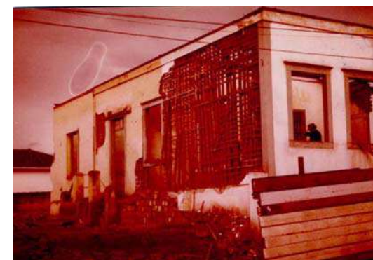
Figura 006 - Demolição da antiga edificação existente para a construção do Paço Municipal. Foto: Robinson A. de Moraes – Fonte: Acervo do escritório Brasil Arquitetura.
