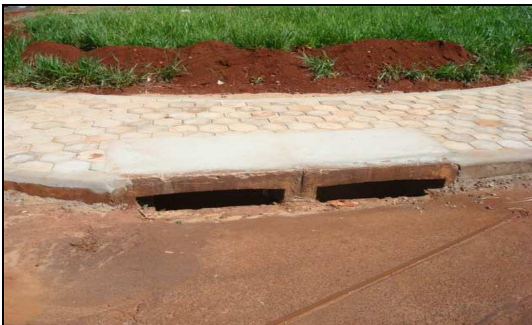
Figura 7.6 – Galeria de água pluvial (Jd. Mariana – Palmital/SP) Foto: E. C. Oliveira, abr./2009
