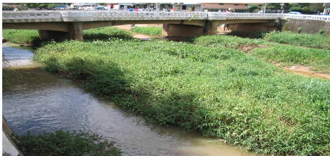
Figura 56 - Assoreamento na ponte do Rio Pirai
