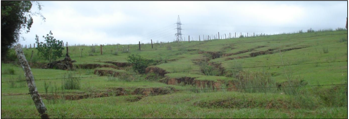
Figura 19 - Processo erosivo desenvolvendo ravina na meia encosta, com várias ramificações.
