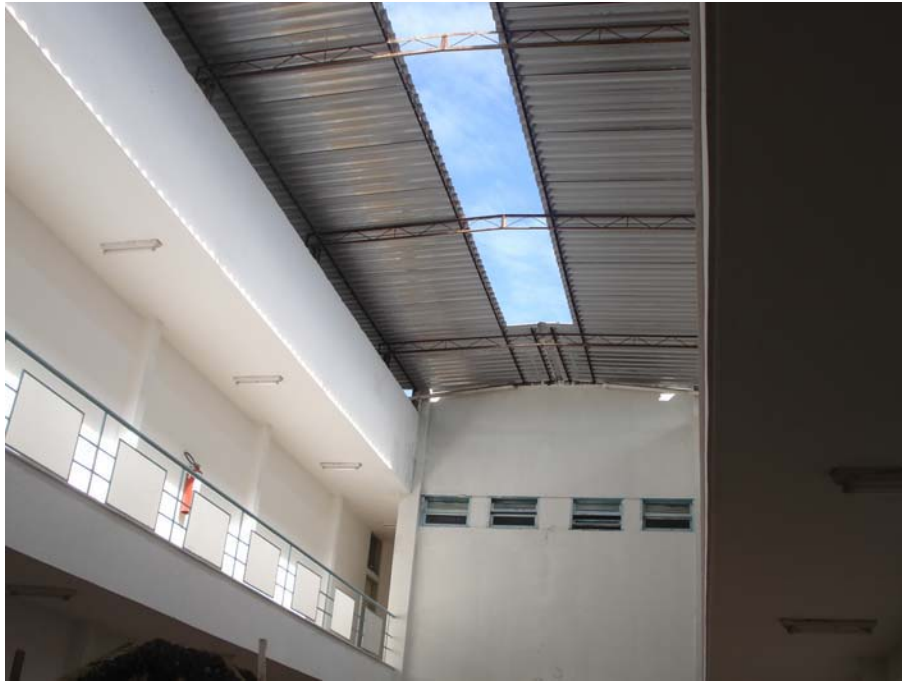
Figura 42. Teto condensado, 2008. Foto nossa.
