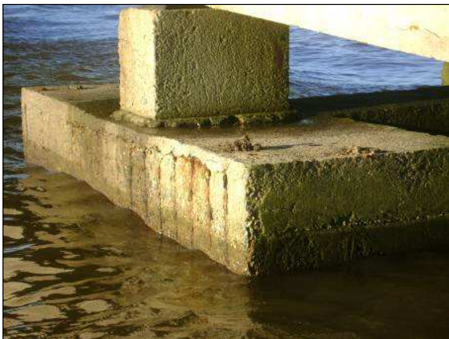
Deposição de fezes em base de ponte.
