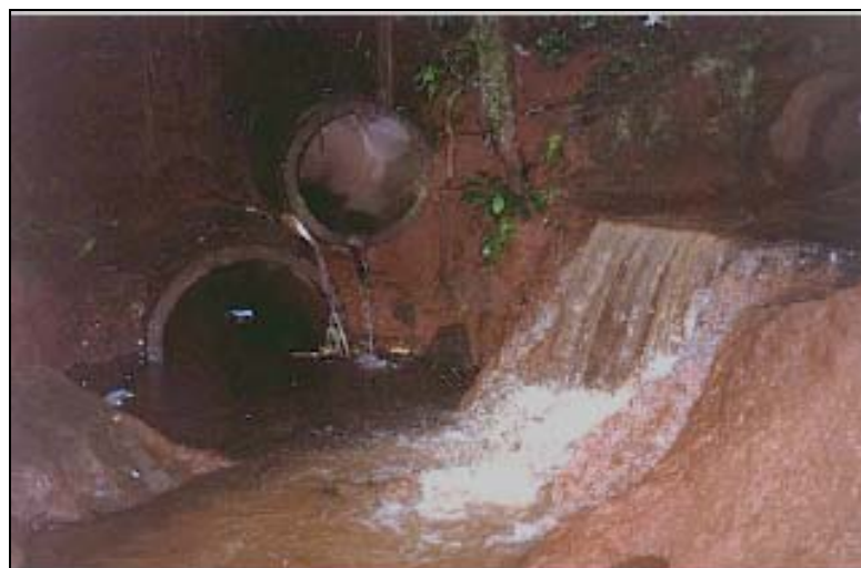
Figura 192: Galerias instaladas no interior do Parque do Ingá. Foto: BOVO, M. C. 2006.
