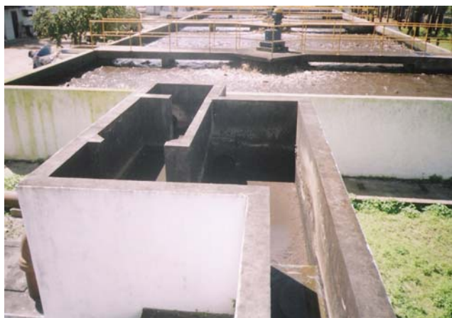
(a) Tanque de aerção e tanque de mistura de lodo recirculado com o esgoto bruto.
