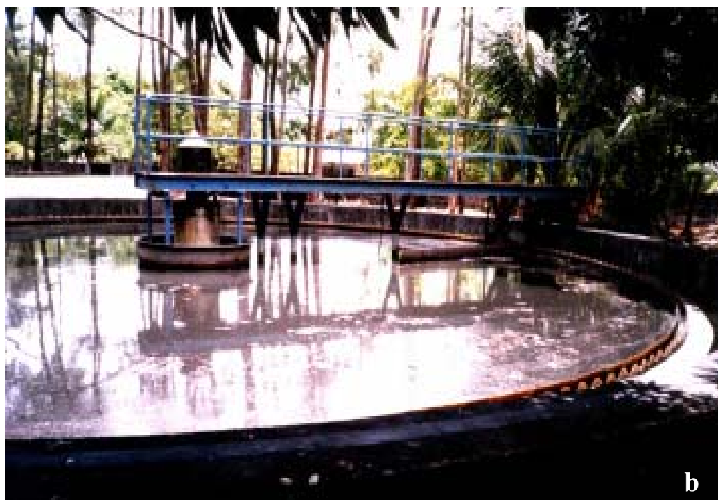
Figura 3.1. tanque de aeração (a) e decantador secundário (b) da ETE Caçote no ano de 2003 (Recife - PE).
