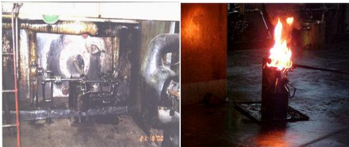
Figura 22 - Queimador original à esquerda e tocha de acendimento à direita
