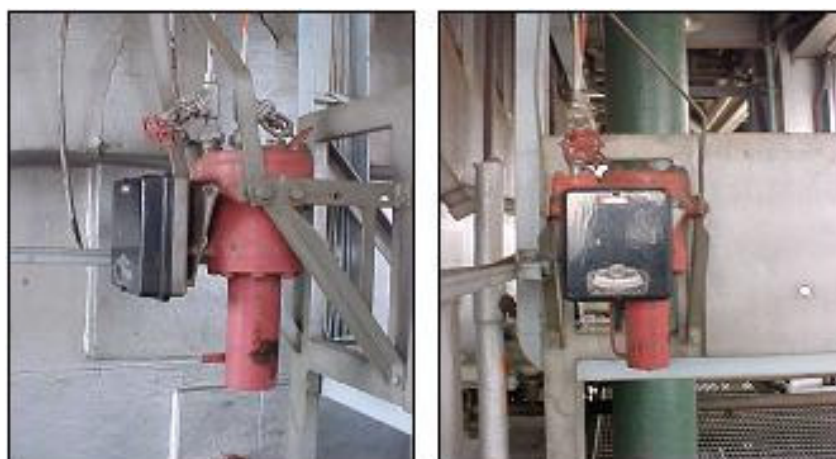
Figura 34 - Medidor e controlador de nível do tambor da caldeira
