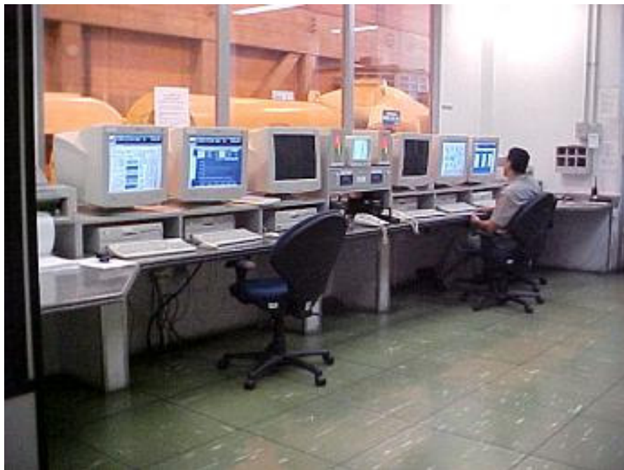
Figura 56 - Nova sala de controle das unidades 1 e 2
