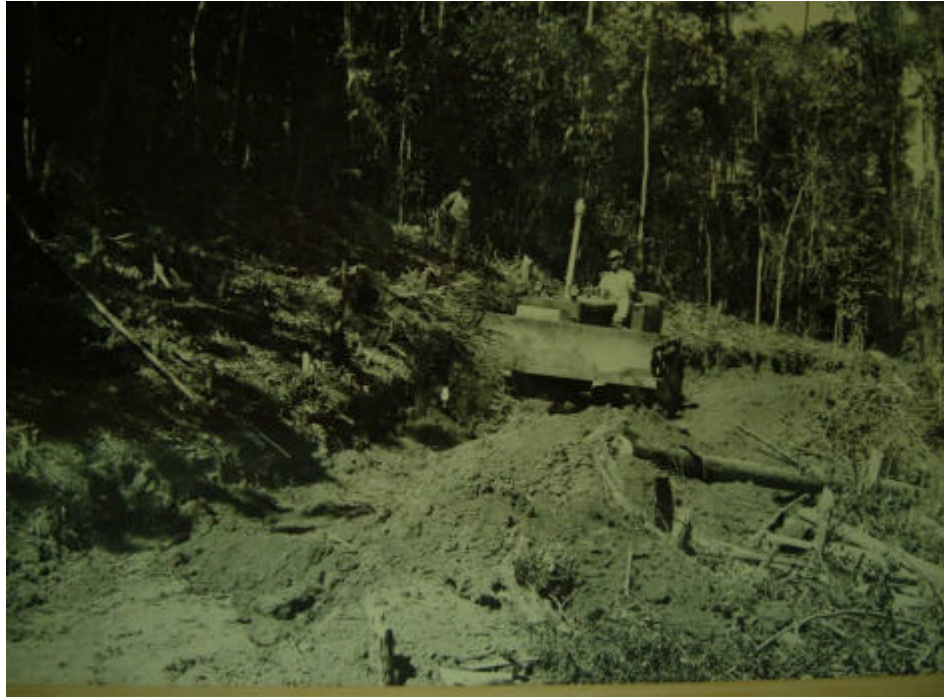
Figura 14 - Militar desmatando área para a abertura de estrada ligando as ex-instalações da Escola de Pesca (futura instalação da Marinha) à Praia da Armação (atualmente local de exercícios militares) - 1972. Também identificado por Silva, 2005.
