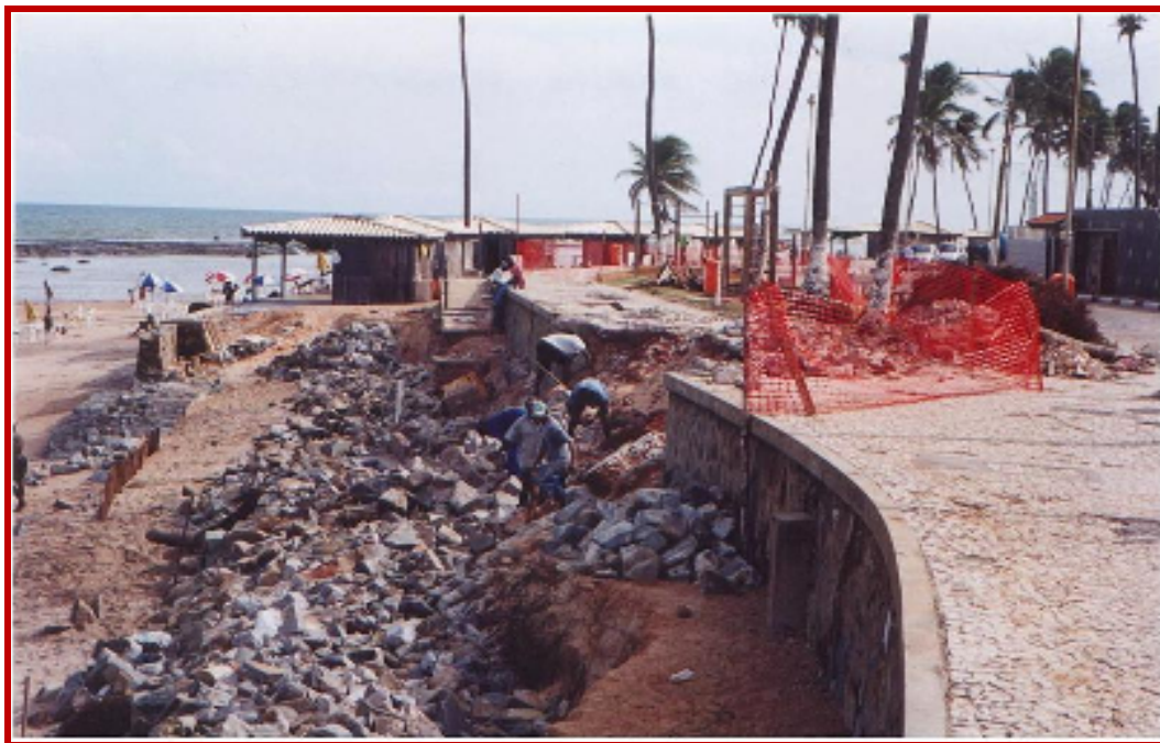
06 – Evidência de erosão marinha na praia de Jauá - Camaçari. Fonte: CRA, 2001
