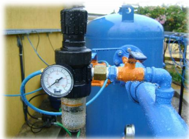
Figura 4.1.2-1 – Derivação da linha de gás para alimentação das válvulas e válvula reguladora
