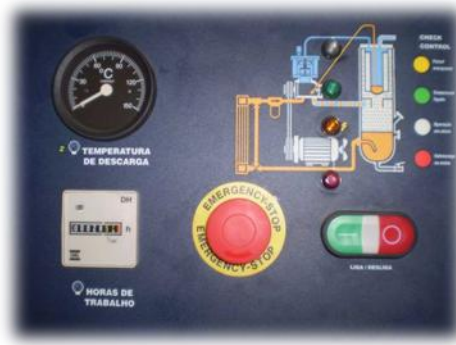
Figura 4.1.1-1 – Painel de ligação do compressor com medidor de temperatura
