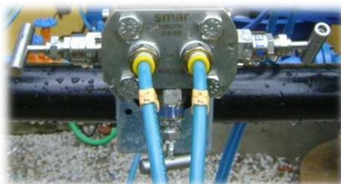
Figura 4.1.7-2 – Manifold do medidor de vazão
