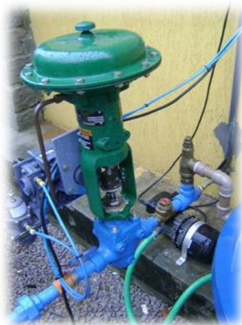
Figura 4.1.5-4 – Bomba alternativa e válvula controladora de vazão de água
