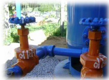
Figura 4.1.4-2 – Válvulas manuais de controle de gás.
