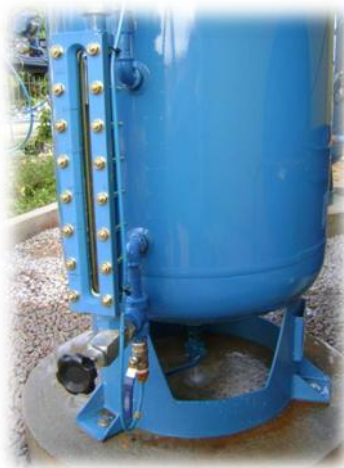
Figura 4.1.5-2 – Medidor de nível no vaso separador – dreno aberto na parte inferior
