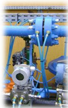
Figura 4.1.7-4 – Flanges que prendem a placa de orifício. Está ligada ao medidor de vazão.
