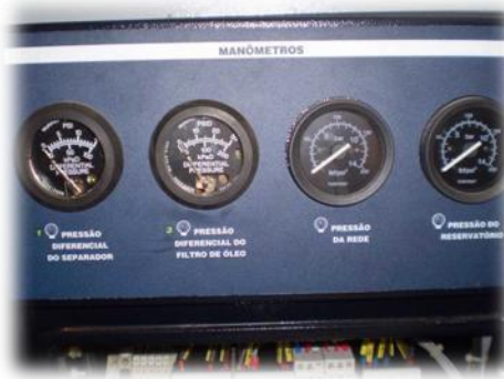
Figura 4.1.1-2 – Medidores das pressões internas
