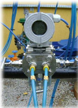
Figura 4.1.7-1 – Medidor de vazão
