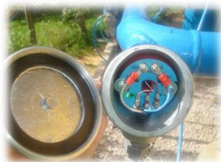
Figura 4.1.8-1 – Sensor de temperatura. Fiação ligada ao CLP que envia sinal de 4-20mA
