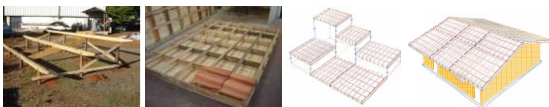
Figura 18: Sistema de cobertura em painéis pré-fabricados em madeira de plantios florestais projetado para o assentamento Sepé Tiaraju. Fonte: desenhos do Ivan do Valle e fotos Grupo Habis, 2007.
