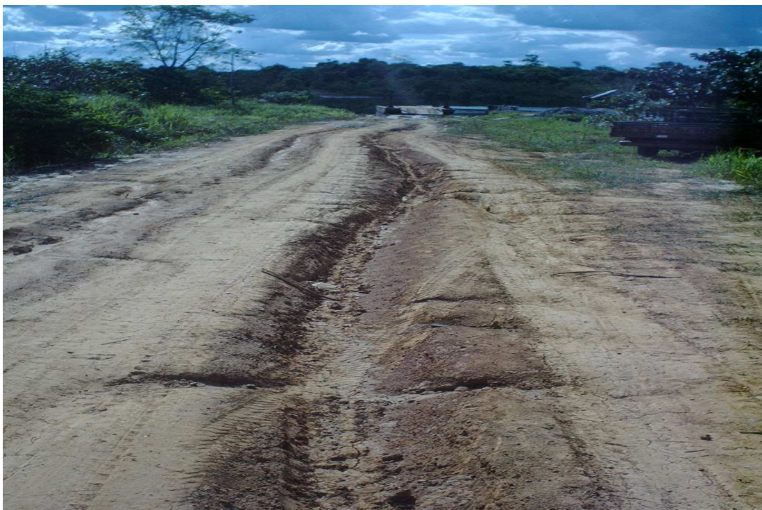
Fig. 6 Rodovia BR- 230, no Estado do Amazonas, sem manutenção. DNIT /2003
