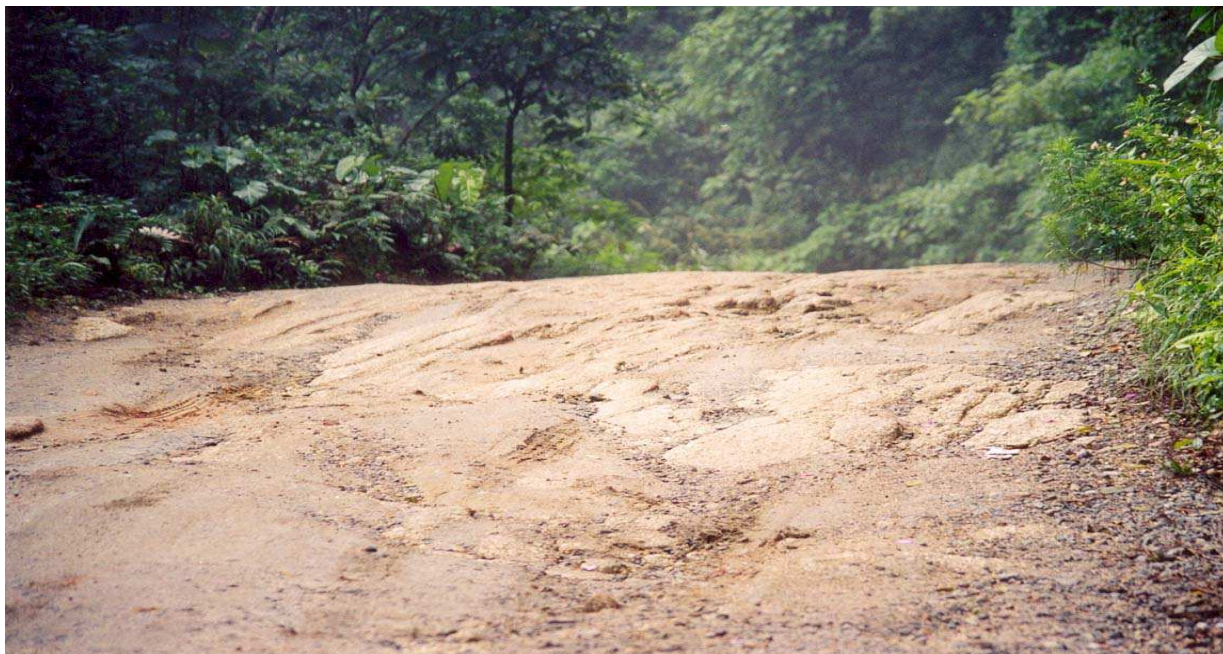
Fig. 4 Leito estradal da RJ-165 – “Paraty-Cunha”, totalmente deteriorado, no interior do PNSB. Foto de Regina Avena e Carlos Saldanha - 2003
