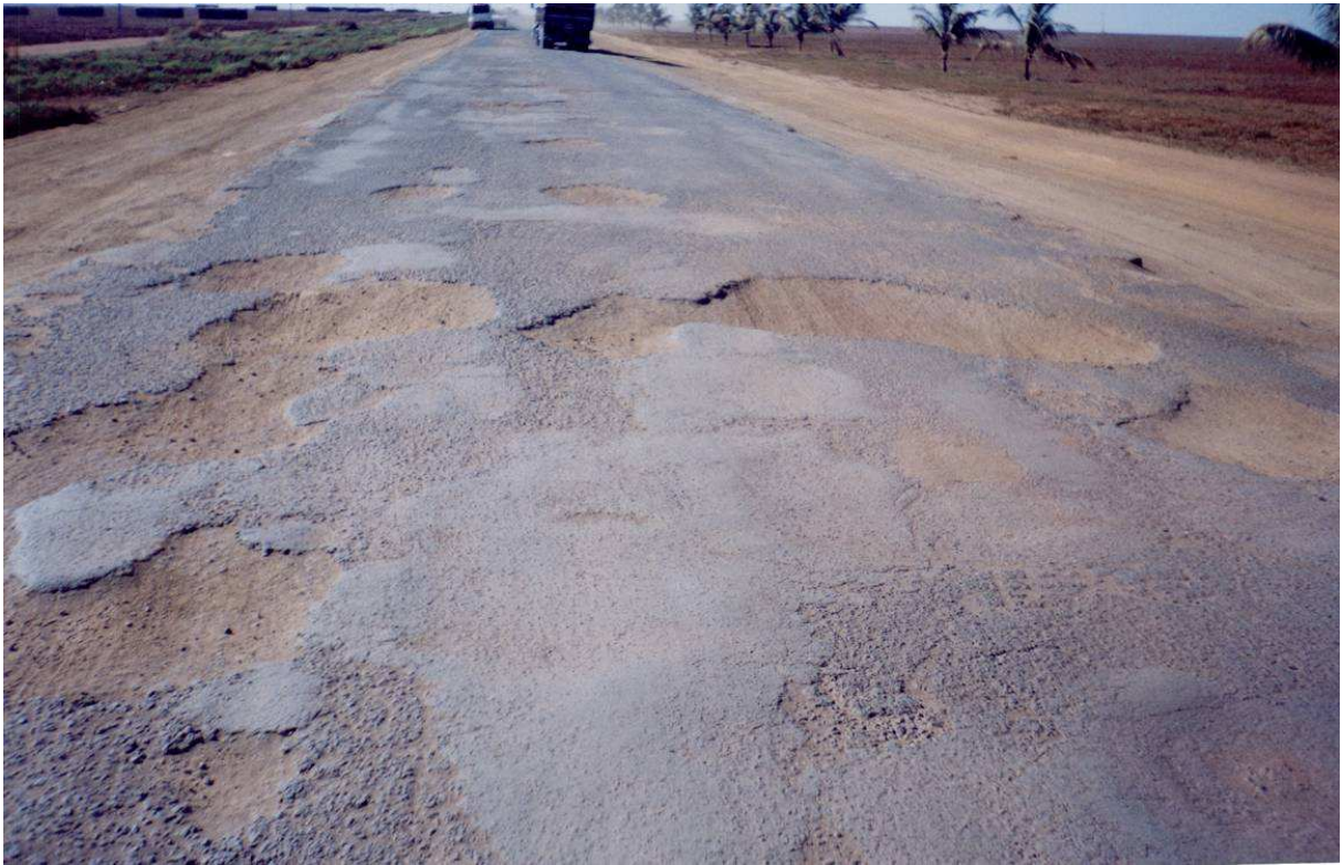
Fig. 9 Leito estradal da BR – 364, Mato Grosso, Km. 115.0, sem conservação. Foto de Regina Avena. DNIT (2003)
