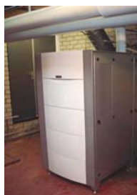
Figura 69: Célula instalada dentro do edifício.
