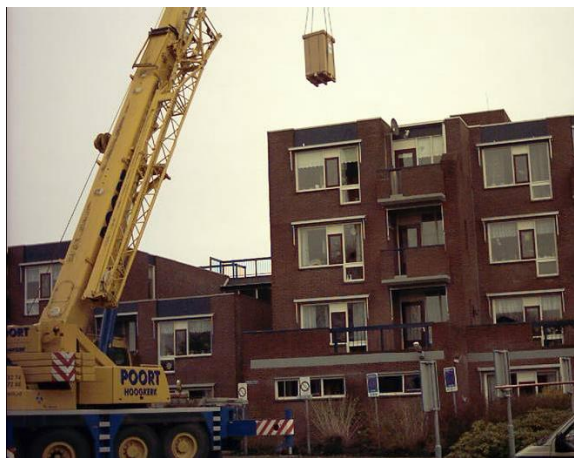
Figura 68: Edifício onde a CaC foi instalada.
