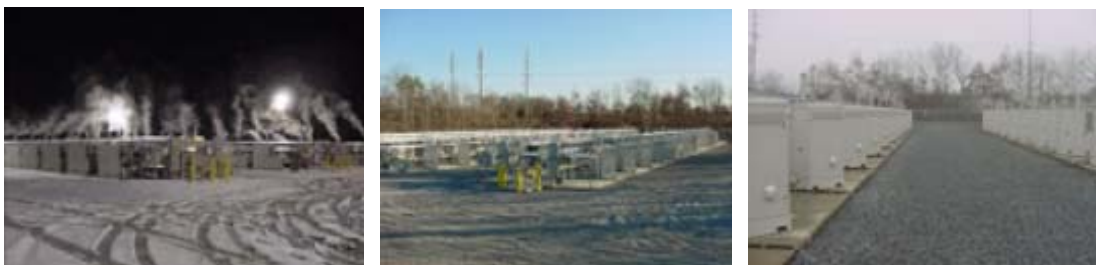
Figura 33. Subestação de West Babylon
