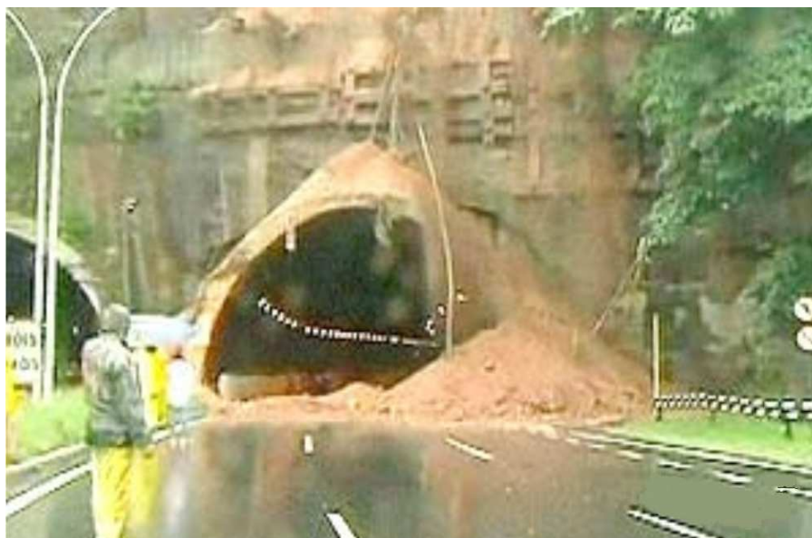
FOTO 2: Deslizamento de terra no túnel Rebouças no Rio de Janeiro
