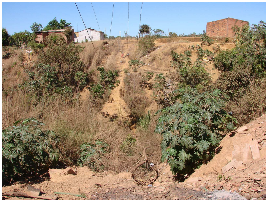
FOTO 7: Encosta erodida com risco de desestabilização
