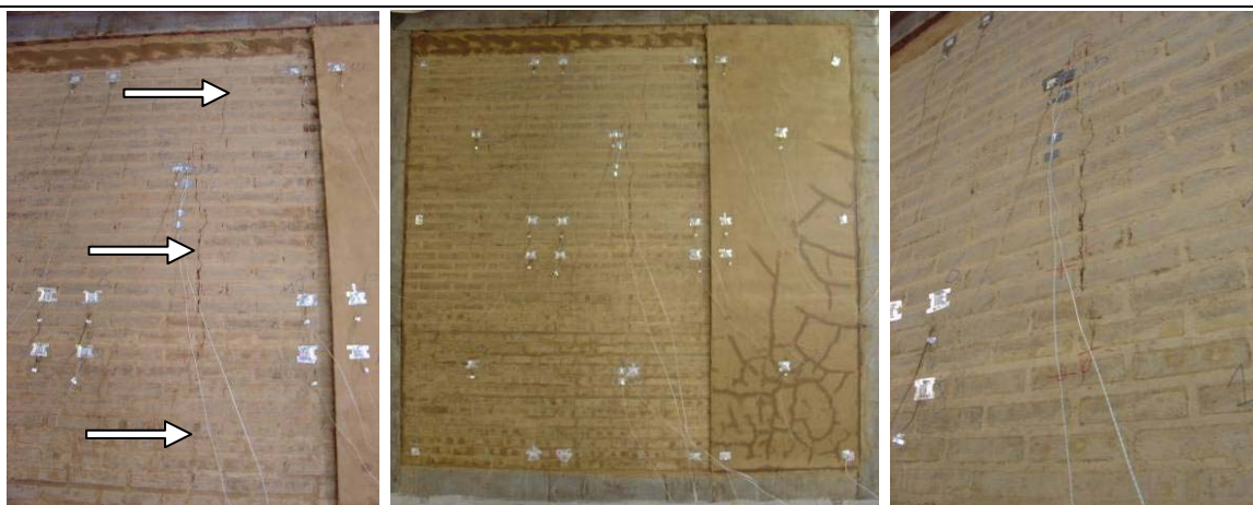
Fig. 63 – Fissura vertical no centro da parede, face não exposta ao fogo.
