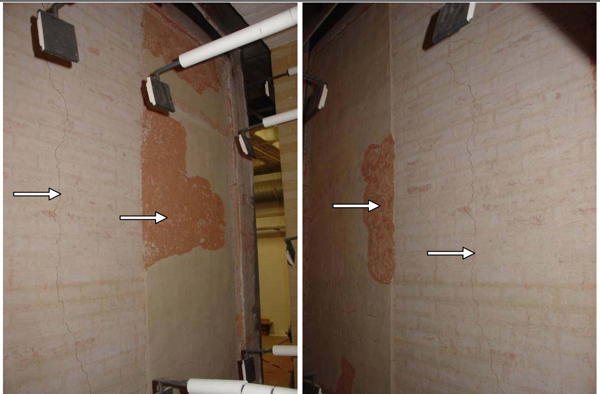
Fig. 64 – Fissura vertical no centro da parede, face exposta ao fogo. Detalhe dos descolamentos de parte das duas faixas laterais de reboco.
