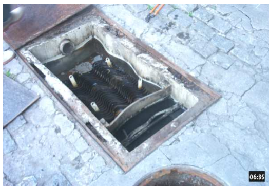
Figura 8.86 – Caixa separadora de placas coalescente na área de lavagem. Aspecto geral do módulo coalescente, da canaleta coletora de óleo (flauta), e da chicana que separa o primeiro e o segundo estágio.
