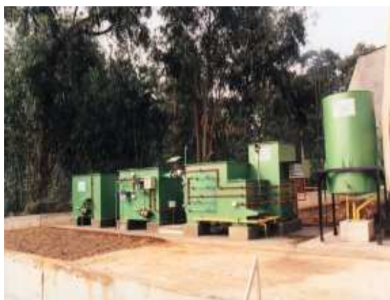
Figura 5.17-Um modelo de um UDSA instalado, com recirculação de águas residuárias. Aquoludsa, Lda. –Portugal, 2005.
