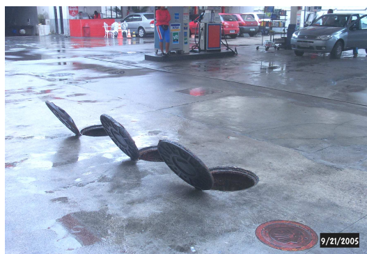
Figura 8.22 – Caixas separadoras A e B (1ª e 2ª caixas) e caixa de passagem da área de abastecimento. Aspecto geral do piso molhado pela chuva, na seqüência da direita para esquerda, as coletas ocorreram na primeira (Caixa A), e na última, caixa de passagem.
