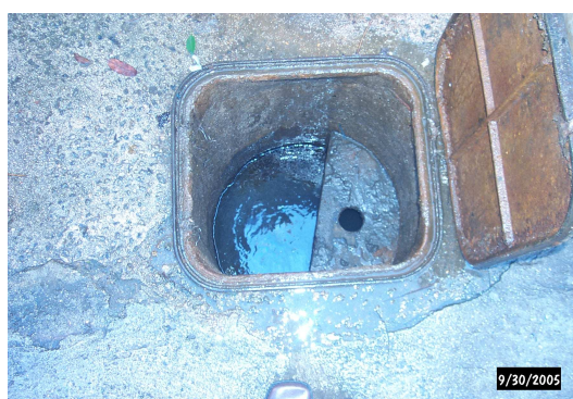
Figura 8.61 – Aspecto geral do SAO B.
