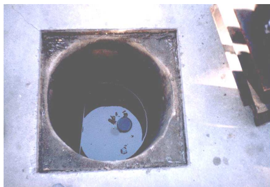
Figura 8.11 – Aspecto do primeiro SAO da área de abastecimento. No detalhe é observada a tubulação de entrada de fundo.
