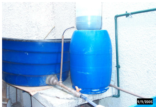
Figura 8.91– Sistema de aplicação de óleo inservível por gravidade (reservatório branco).
