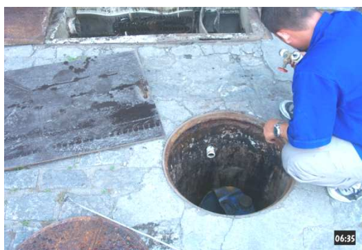
Figura 8.89 – Aspecto da caixa coletora de óleo 15 .
