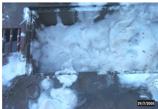
Figura 8.9 – Caixa de areia da área de lavagem de veículos repleta de espuma proveniente do detergente automotivo utilizado na lavagem de carroceria.
