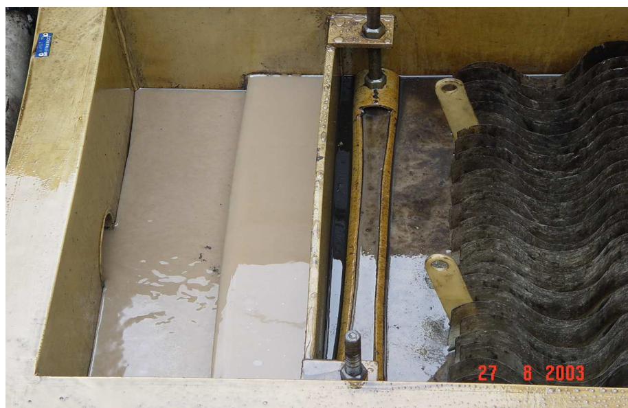
Figura 5.13 – Separador de placas coalescentes recebendo efluente de lavagem de veículos e operações desengraxantes. Fonte: Relatório de avaliação do separador água e óleo instalado na gerência de transporte (IGT). COMLURB, 2003.
