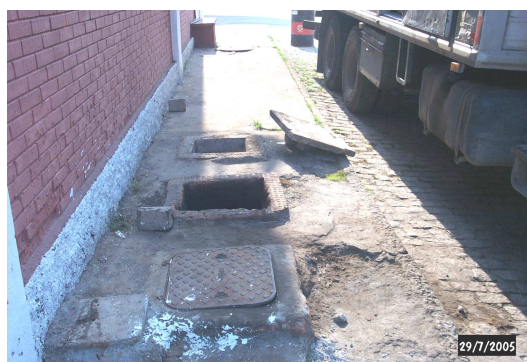
Figura 8.17 – Seqüência do sistema separador água e óleo do posto que encontrava-se danificado.
