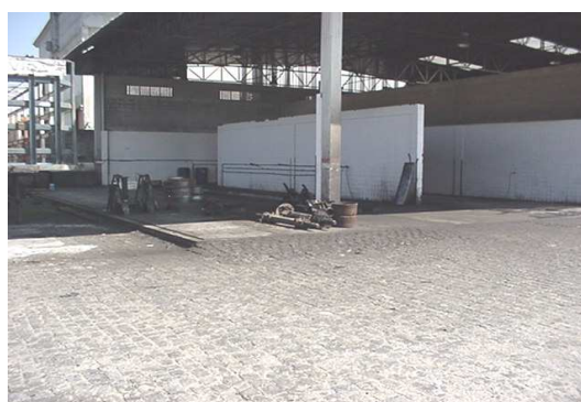
Figura 8.27 – Aspecto geral da área onde são realizados os serviços de lavagem de caminhões e limpeza de peças.
