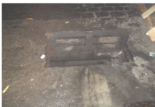
Figura 8.40 – 1º ralo de drenagem pluvial onde foi coletado o efluente após o SAO 4, representando a área de lavagem interna e a área de lavagem de chassi.
