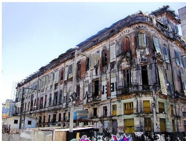
Figura 38: Fachada do Edifício Chanteclair em estágio avançado de degradação.
