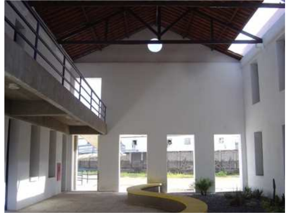
Figura 142. Mesma parede vista a partir o interior. Detalhe da cobertura interrompida. Fonte: IBA
