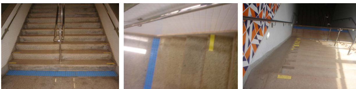
Ilustração 23 – Fotos das escadas da Estação de Metrô 108 Sul com e sem a sinalização adequada.
