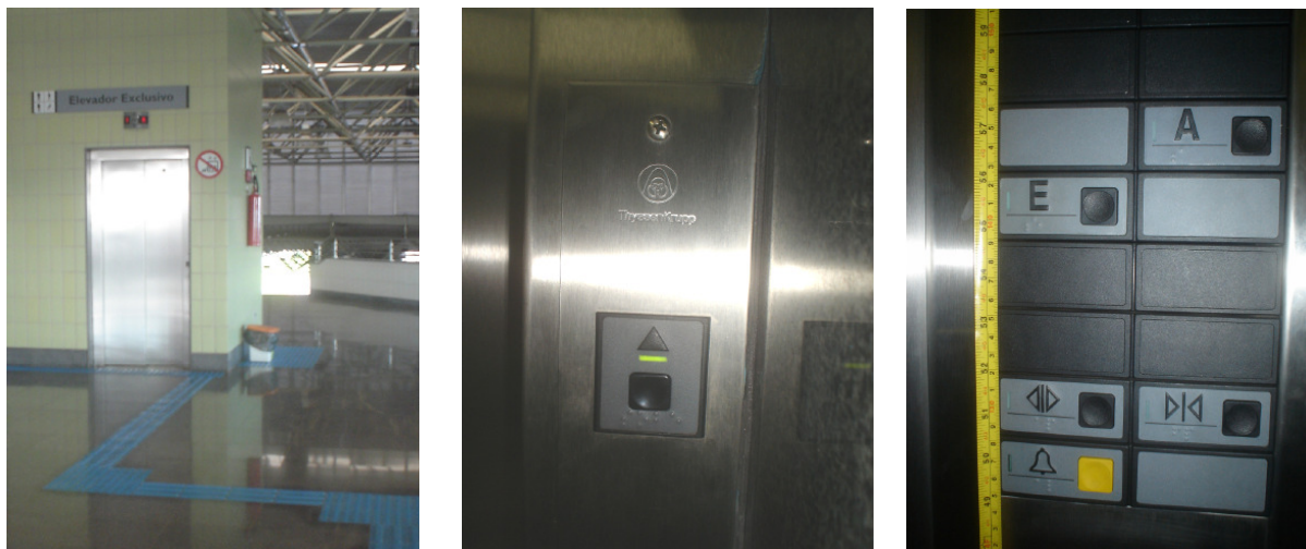
Ilustração 41 – Fotos dos elevadores da Estação de Metrô Terminal Ceilândia sinalizados com piso tátil e com botoeiras com caracteres em braille.
