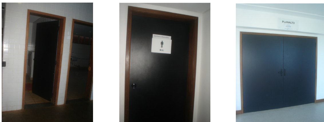
Ilustração 56– Fotos das portas do Centro de Convenções sem a sinalização adequada.
