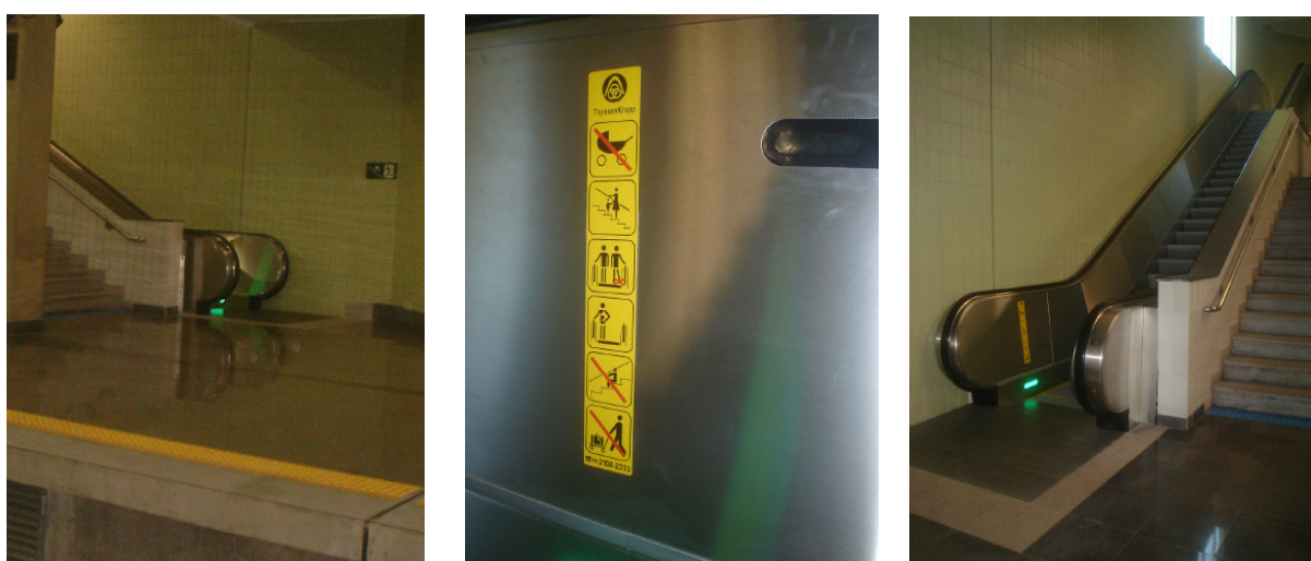
Ilustração 38 – Fotos das escadas rolantes da Estação de Metrô Terminal Ceilândia sem a sinalização exigida pela norma técnica.
