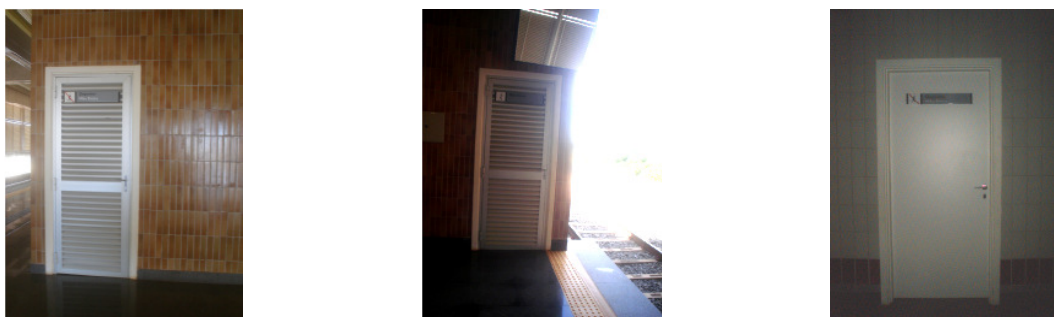
Ilustração 21 – Fotos das portas da Estação de Metrô Guariroba com sinalização incorreta.
