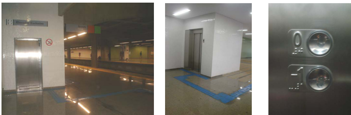
Ilustração 39 – Fotos dos elevadores da Estação de Metrô 108 Sul sinalizados com piso tátil e com botoeiras com caracteres em braille.
