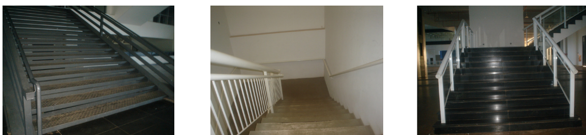
Ilustração 59 – Fotos das escadas fixas do Centro de Convenções sem a sinalização recomendada pela norma técnica.
