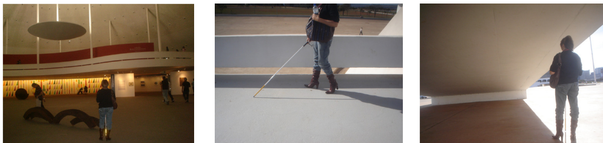
Ilustração 83 – Fotos do local de exposições sem o a sinalização tátil no piso, rampa com o guarda-corpo menor que o exigido norma técnica e sem corrimão, e rampa (funcionando como um obstáculo suspenso) sem sinalização adequada na parte inferior, passeio acompanhado com Isabel no Museu Nacional.
