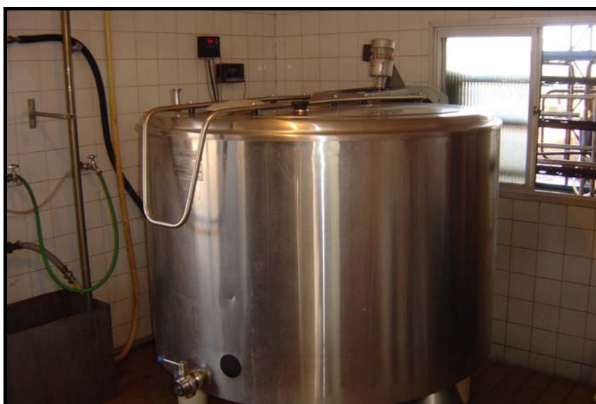
Figura 3.2 Tanque de resfriamento do Centro de Treinamento da ESALQ/USP, em Piracicaba, SP, onde foi realizada a segunda amostragem
