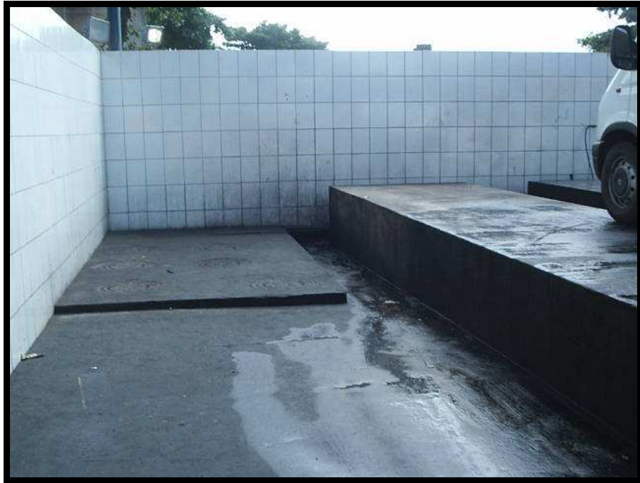
Figura 4.5 - Caixa separadora de água e óleo
