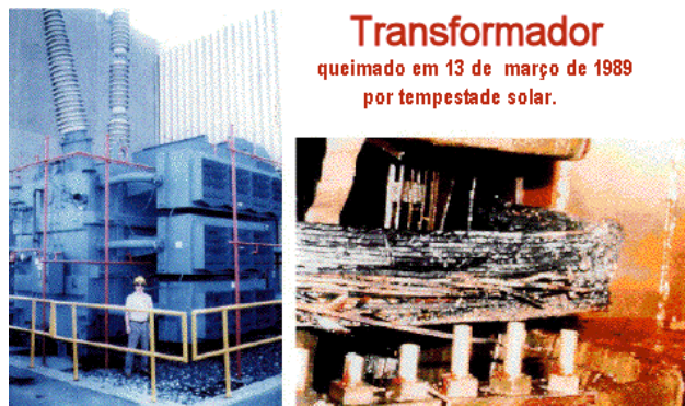
Figura 1.4- Transformador da hidroelétrica de Quebec no Canadá queimado na tempestade solar de março de 1989
