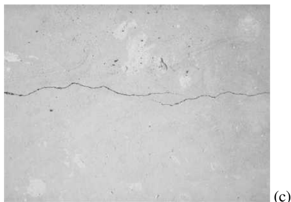
Figura 4: exemplos do mau uso do reescoramento. (a) escoramento no meio do vão da laje (TECHNE, 2005). (b) fissura devida à formação de um momento fletor negativo por conta de um reescoramento mal executado. (c) fissura, ainda não tratada, decorrente do momento negativo.
