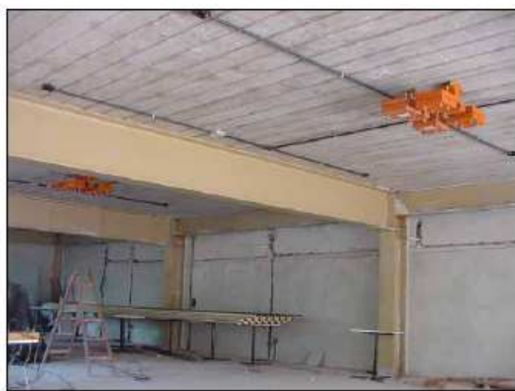
Figura 2.11 – Atenuador Dinâmico Sintonizado instalado (Varela,2004)
