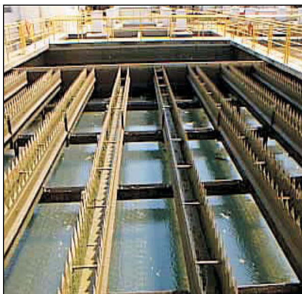
Figura 2.16 – Decantador sendo esvaziado para lavagem. Fonte: Reali (1999).
