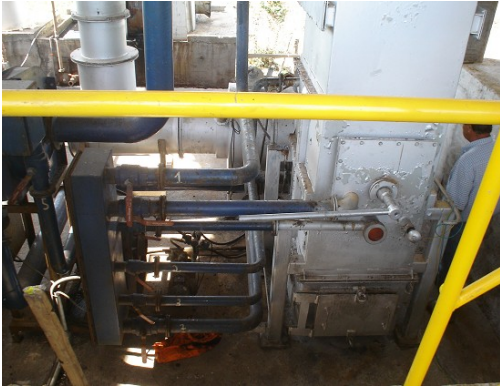
Foto 5 - Câmera do incinerador e grelha.
