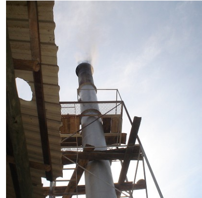
Foto 6 - Chaminé do incinerador.
