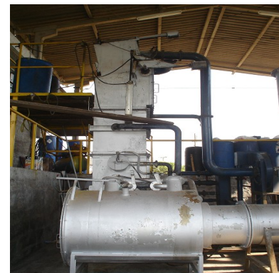
Foto 2 - Incinerador de resíduos – acesso restrito.
