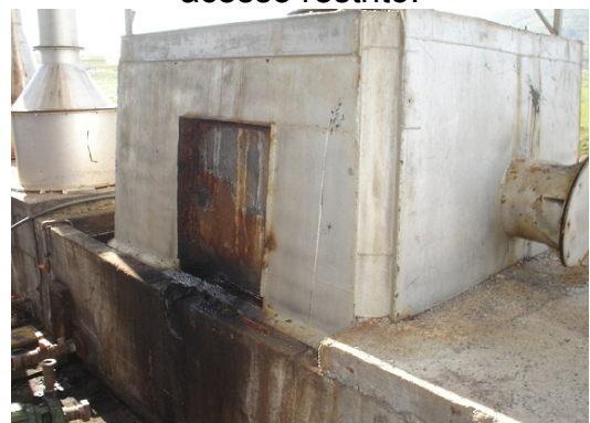
Foto 4 - Lavador de gases.
