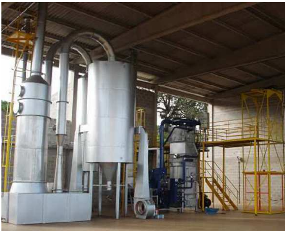
Figura 15 – Exemplo de incinerador instalado pelo fabricante consultado
