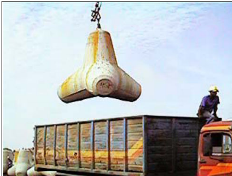
Figura 8.3 – Estrutura em forma de tetrápode utilizada na ampliação dos molhes de Rio Grande –RS (GUIMARÃES ET AL., 2003).
