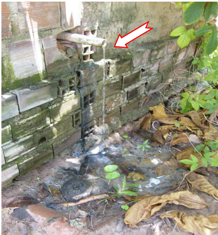
FIGURA 63: Encanação residencial voltada para o terreno vizinho.
