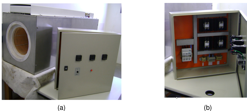
Figura 5.9. (a) Conjunto completo do sistema de aquecimento e (b) interior da caixa de comando.
