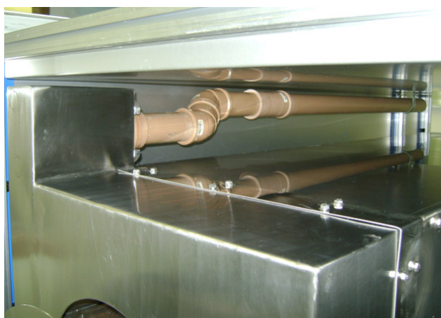
Figura 5.65. Tubulação do sistema de exaustão.
