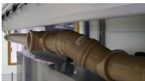
Figura 5.67. Ponto de conexão do sistema de exaustão do forno com a rede externa.
