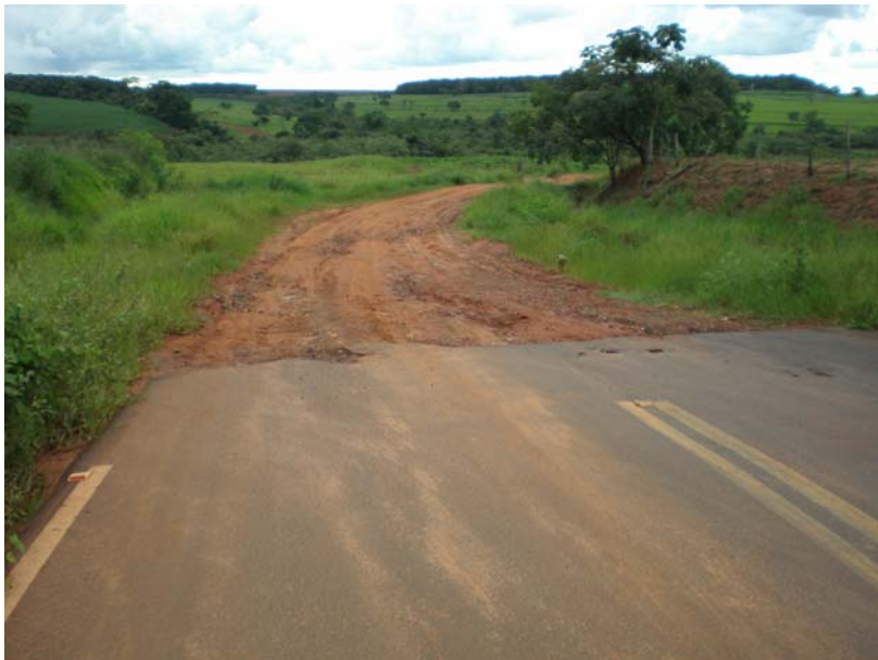
Figura 306. Estrada municipal Uchoa-Guapiaçu aterrada com entulho
