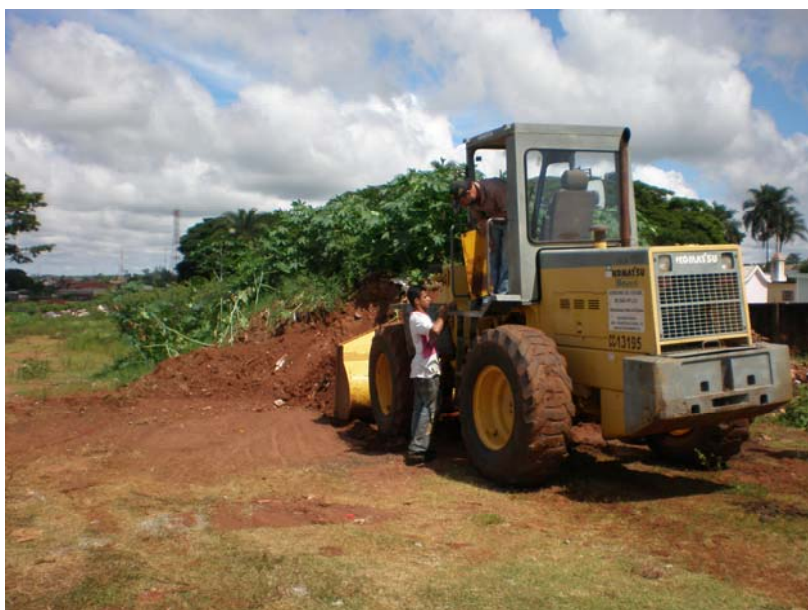
Figura 114. Depósito de RCD ao lado do cemitério municipal de Cajobi
