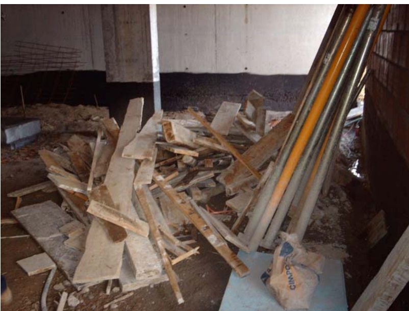
Figura 334. Acúmulo de madeira de fôrma inservível após sua reutilização
