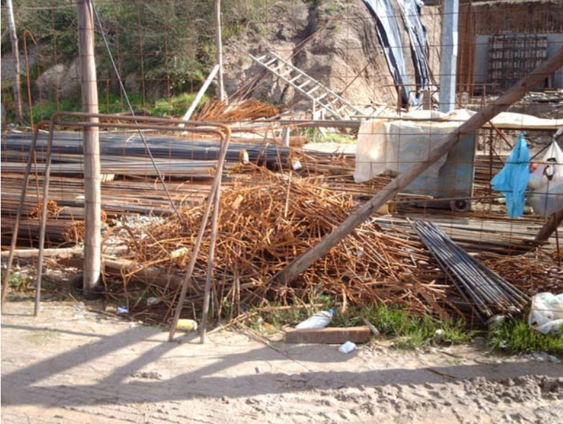
Figura 333. Ferros retorcidos oriundos das perdas das armações da estrutura
