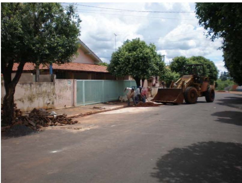
Figura 94. Sistema de coleta pública de entulho de Américo de Campos FOTO: AUTOR (2009)
