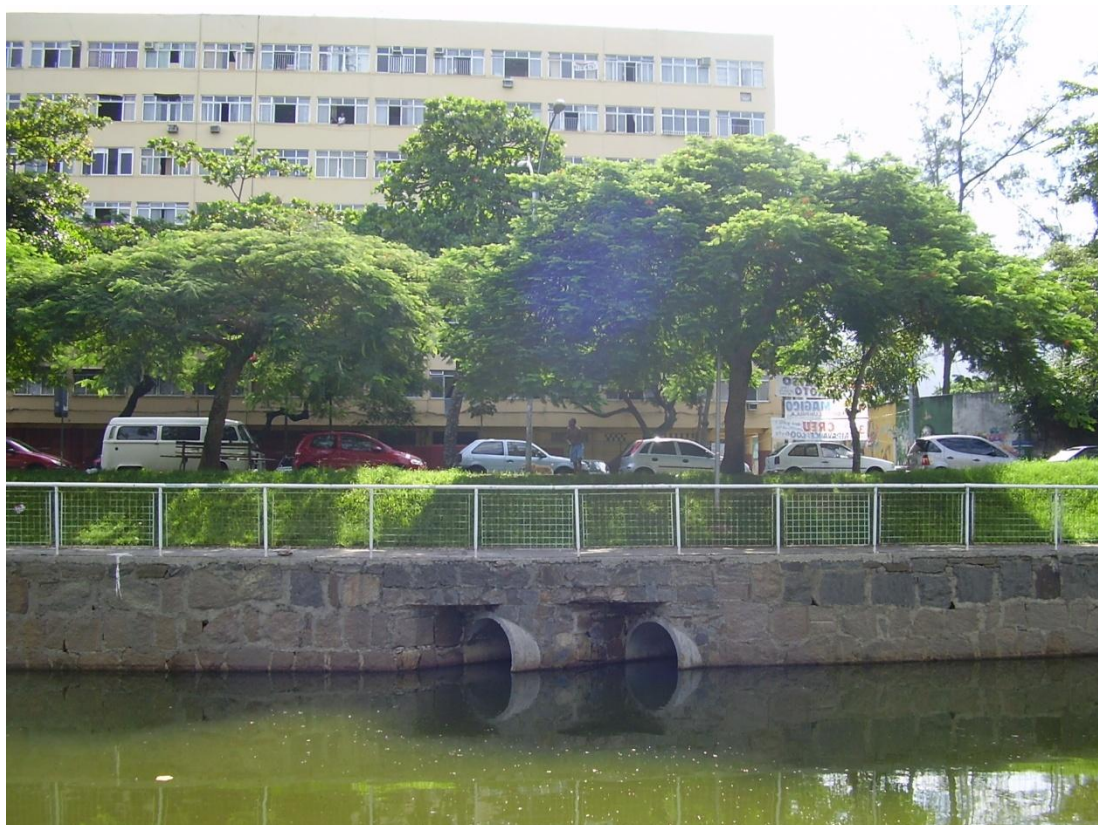
Figura 6.15 - Aporte de águas pluviais em frente à Cruzada São Sebastião.
