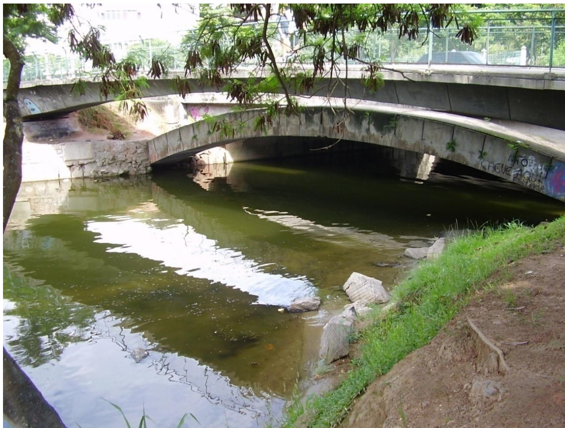
Figura 6.10 - Saída de água da LRF no Clube Caiçaras.
