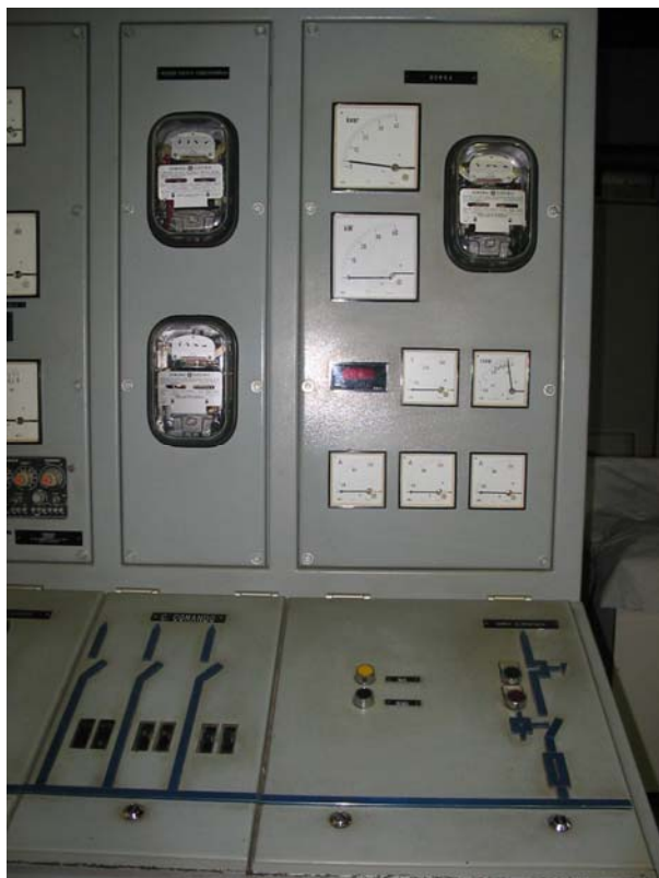
Figura C.7: Detalhe do painel de controle da bomba
