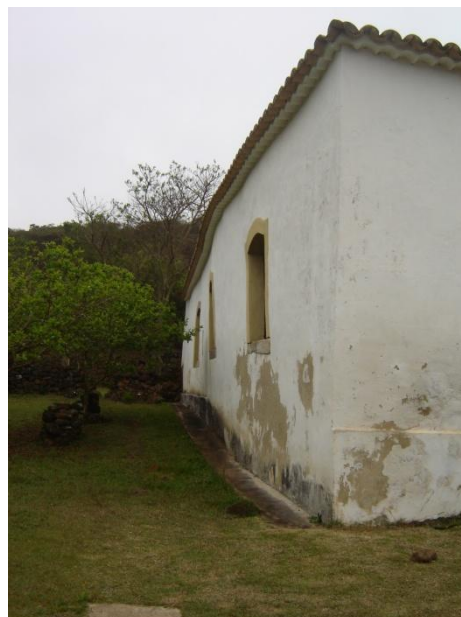
FIGURA 80 – [Sede da fazenda São José do Manso, Ouro Preto: vista do perfil de uma das fachadas com sinais da consequência da desestabilização]
