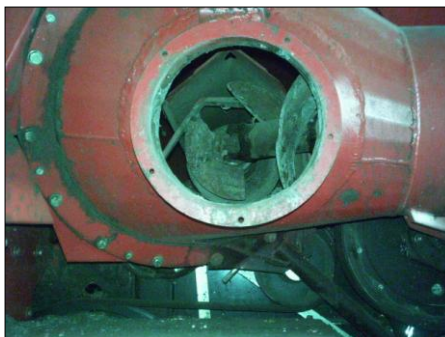
Figura 20 - Abertura no tubo de descarga.
