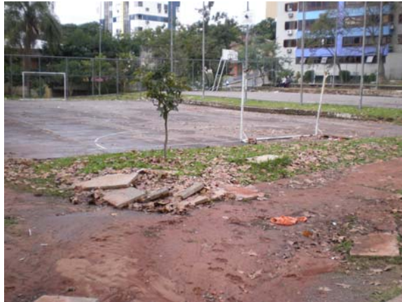
FIGURA 19: Imagem de alagamento no Calçamento do parque.
