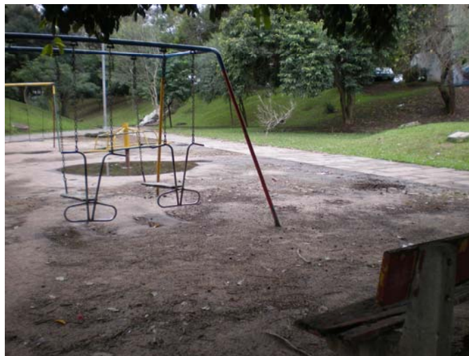
FIGURA 18: Imagem de área de recreação em condições precárias.
