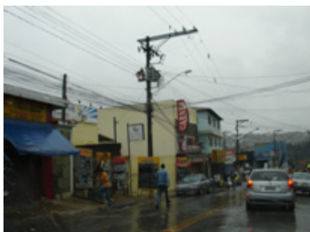
Imagens 13 - Luminária pública quebrada, pendente em poste na rua principal do município de Itapeverica da Serra
