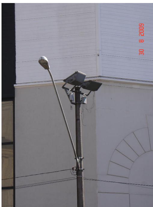
Imagem 101 - Projetores da fachada do Shopping. Fonte: Isac Roizenblatt, 2009.
