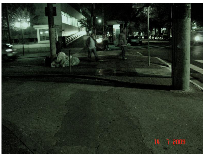
Imagem 83 - Pavimentação com irregularidades. Fonte: Isac Roizenblatt, 2009.
