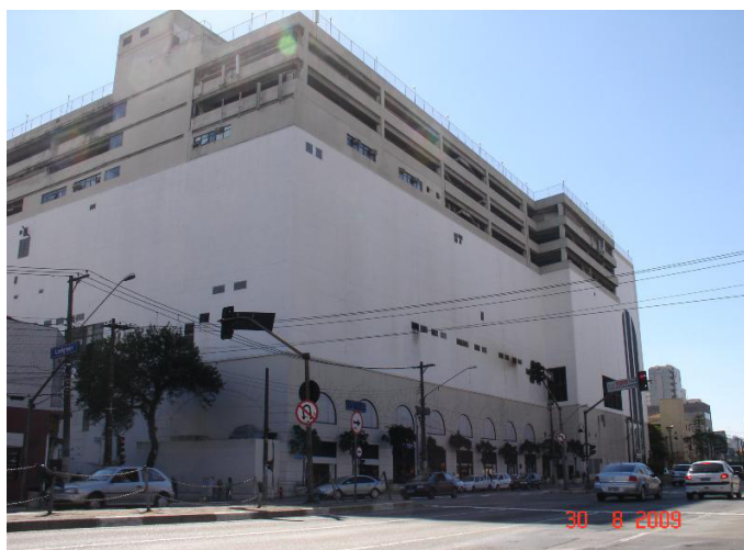
Imagem 103 - Vazados na fachada do Shopping. Fonte: Isac Roizenblatt, 2009.
