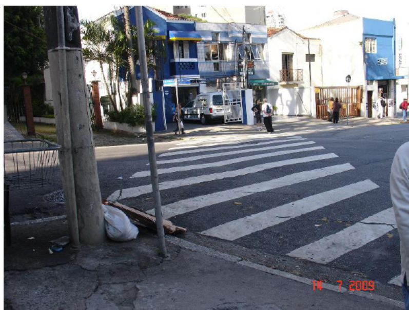
Imagens 58 - Ausência de rampas. Fonte: Isac Roizenblatt, 2009
