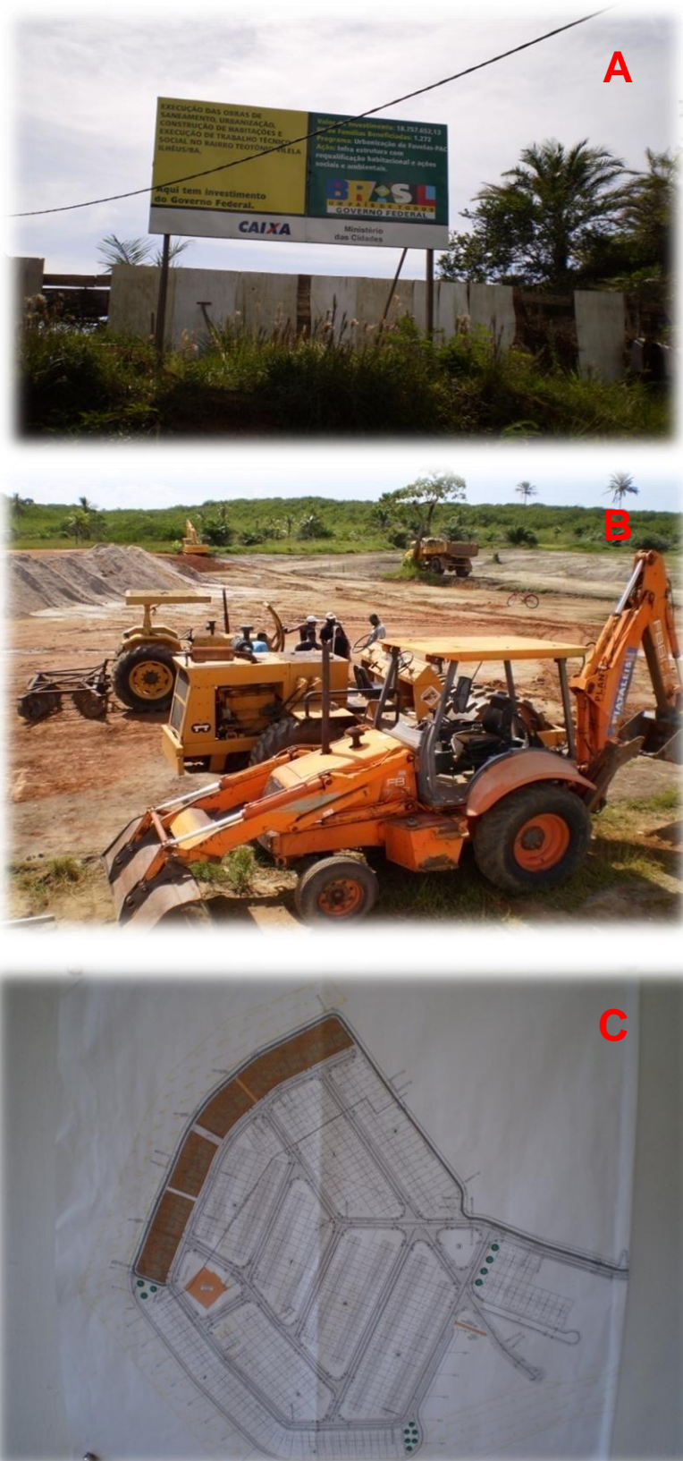
Figura 11: Fotos das obras do PAC – Programa de Aceleração do Crescimento, no bairro Teotônio Vilela – Ilhéus (BA) (A) Placa da obra do PAC (B) Terraplanagem (C) Projeto arquitetônico das 282 unidades habitacionais
