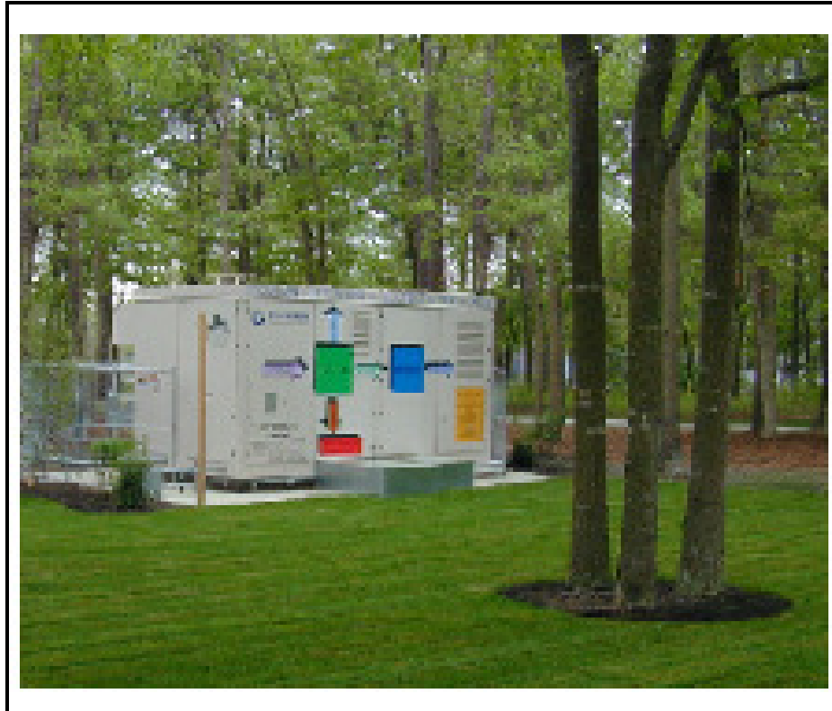
Figura 3-9 - Pilha de ácido fosfórico da UTC Power (200 kW), Stockton College, N. Jersey
