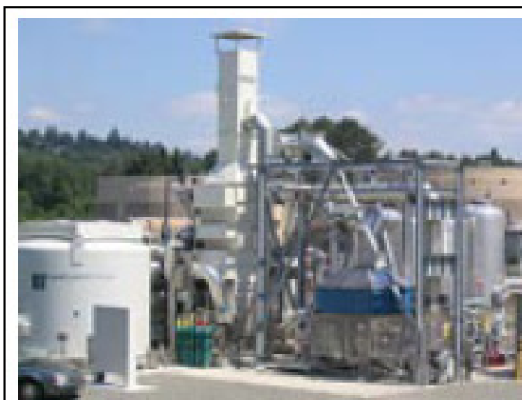
Figura 3-13 - Unidade de produção de energia utilizando MCFC de 1MW , South Treatment Plant .
