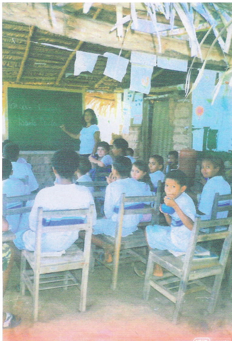
Foto: Suelayne Lima da Paz. 2000. Ilustração 7 — condições precárias de uma escola no Bico do Papagaio em um assentamento.
